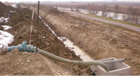
Pozzo di asporto percolato vista lato Bacchiglione
