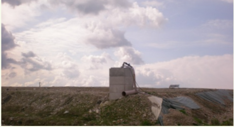
Pozzo percolato vista lato Brenta
